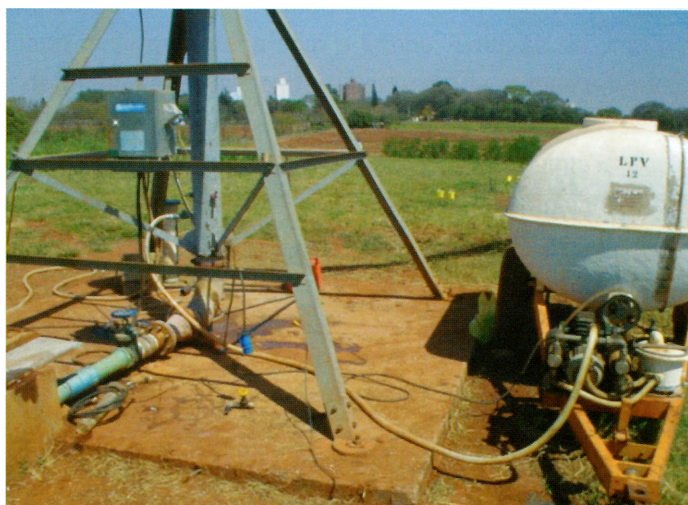
Figura 8 - Tanque de armazenamento de calda fertilizante com bomba injetora
