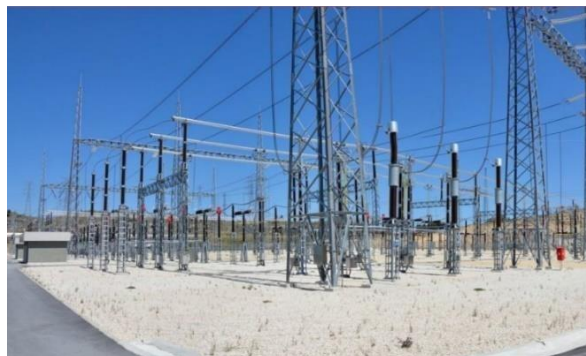
Subestação. Fonte: Efacec
