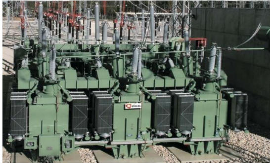
Transformador de potência. Fonte: Efacec
