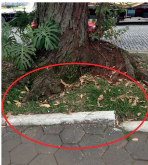
Figura 20. Levantamento da calçada e do passeio causado pela raiz de E. robusta na praça Getúlio Vargas, no município de Nova Friburgo, RJ.
