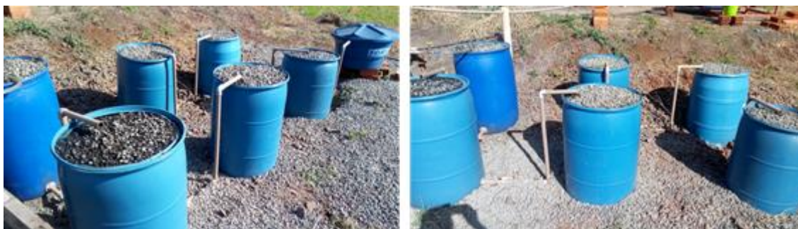
Figura 1. Sistema de tratamento de efluentes de esgoto doméstico em filtros anaeróbios.
