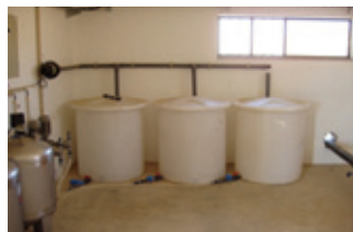
Figura 2. Sistema de fertirrigação.
