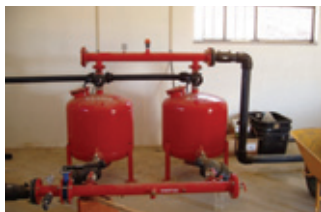
Figura 1. Sistema completo de filtragem.
