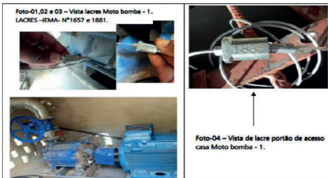
Figura 4. Registro de captação irregular da água do rio Itauninhas.
