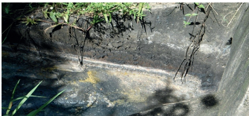
Figura 2. Lançamento de esgoto sem tratamento.
