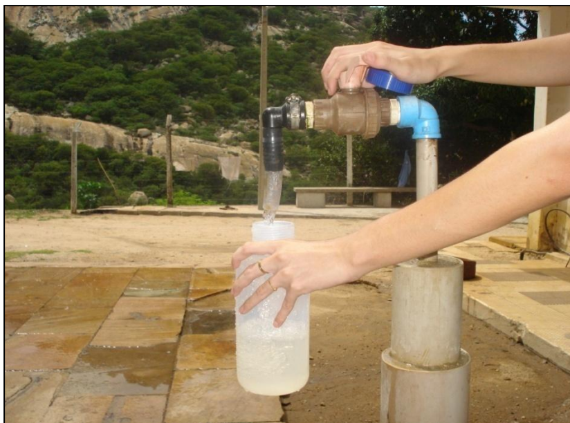
Figura 3.18 – Ponto de coleta de água bruta, derivação da adutora a 10 m da ETA.
