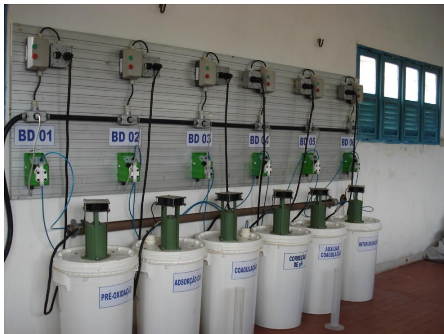
Figura 3.14– Bombas dosadoras, agitadores e bombonas de solução de produtos químicos.
